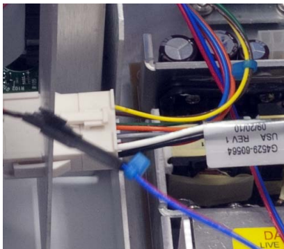
図 31 ケーブル接続
