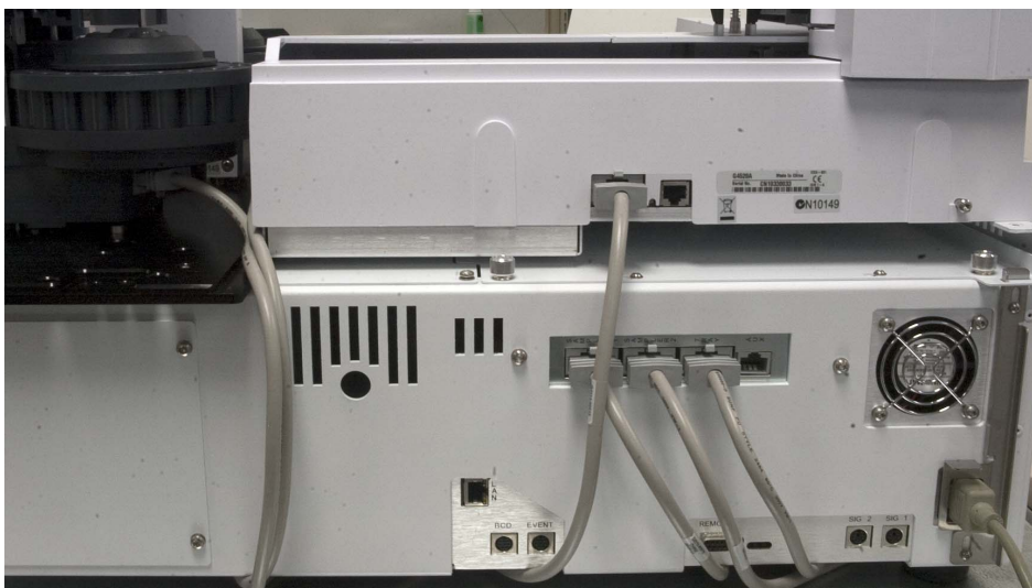
図 23 ケーブル接続ポート
