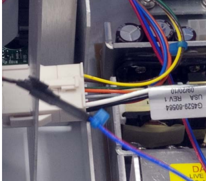
Figura 31 Collegamento dei cavi
