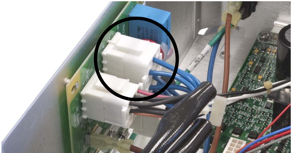
図 2 コンフィグレーションプラグの取り付け
