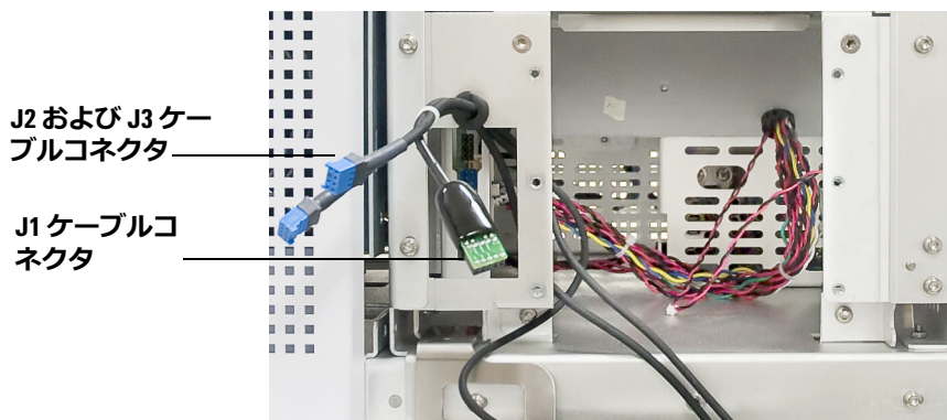
図 10 LTM ケーブル接続
